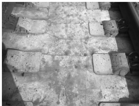
Рис. 3. Трещины на поверхности опытного участка безбалластной конструкции верхнего строения пути
