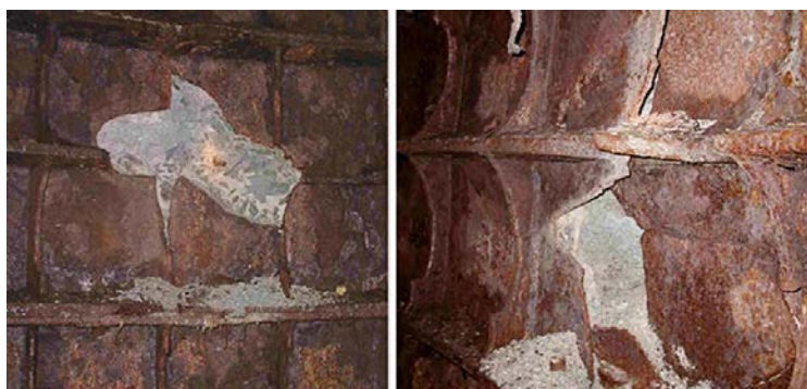
Рис. 1. Разрушение обделок стволов вследствие замерзания воды за обделкой
