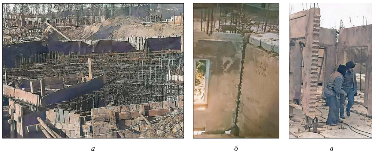
Рис. 1. Возведение жилого здания с использованием рекомендаций кафедры «Здания» в г. Севербайкальске (МПС ЛИИЖТ): а — нулевой цикл; б — надземные конструкции панельного здания серии 122; в — монтаж стеновых панелей здания серии 122 (источник: фотографии из архива кафедры «Здания» ЛИИЖТ и личного архива Т. А. Белаш)
