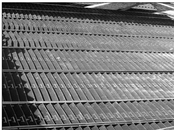
Рис. 2. Реконструкция отстойников КОС С.-Петербурга, секция радиального отстойника с установленными тонкослойными полочными блоками (вид сверху)
