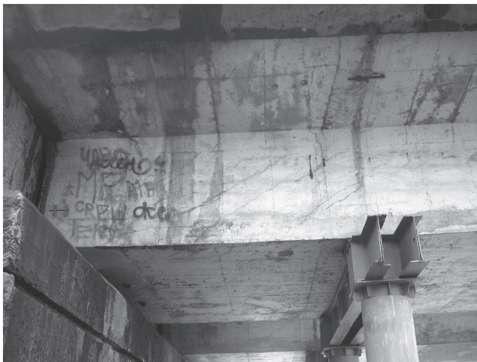
Рис. 2. Разрушение бетона пролетного строения над временной страховочной опорой
