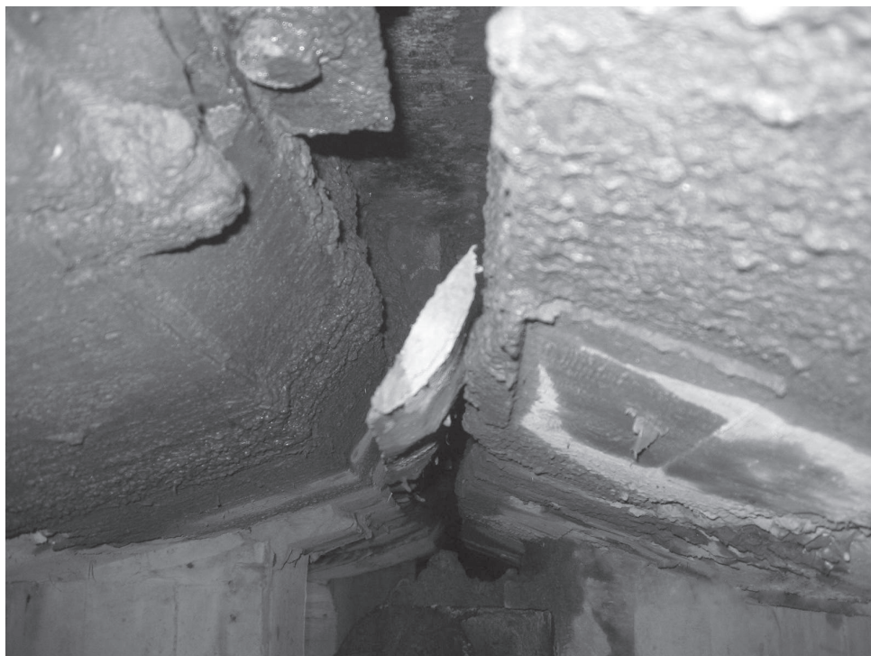
Рис. 3. Разрушение стыков пролетных строений
