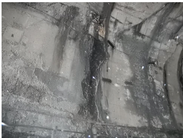
Рис. 3. Зоны деструкции бетона
