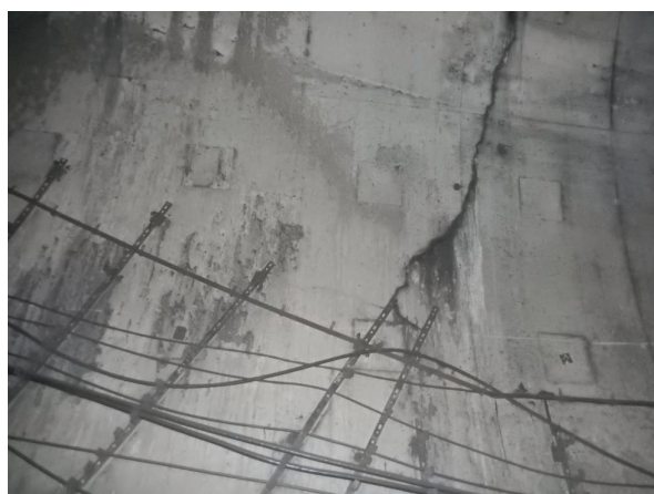
Рис. 1. Трещина в обделке
