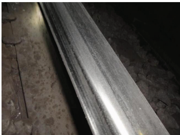
Рис. 6. Боковой износ головки наружного рельса в кривом участке пути
