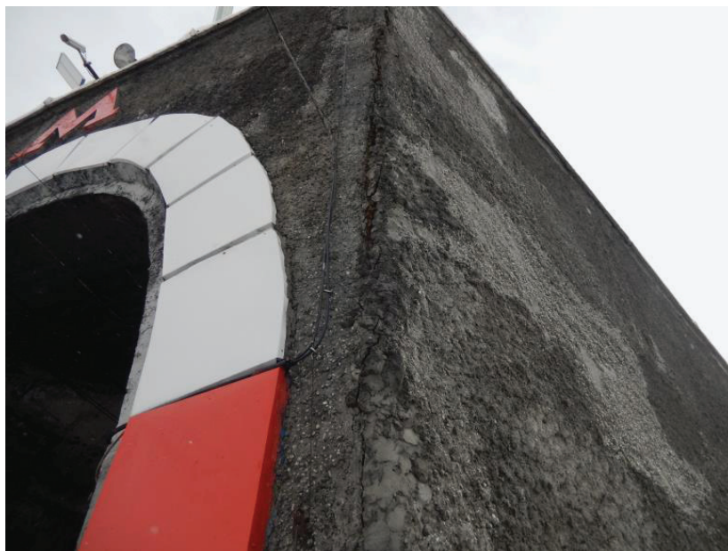
Рис. 5. Вертикальная трещина между порталной стеной и откосом
