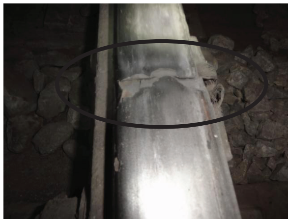
Рис. 7. Дефектный стык с отслоением и выкрашиванием металла
