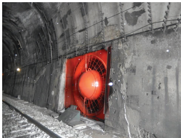
Рис. 4. Вентилятор в сбойке у западного портала
