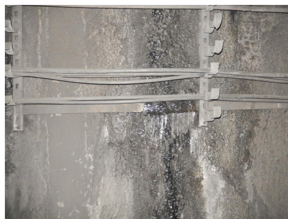
Рис. 2. Наледь на поверхности бетона
