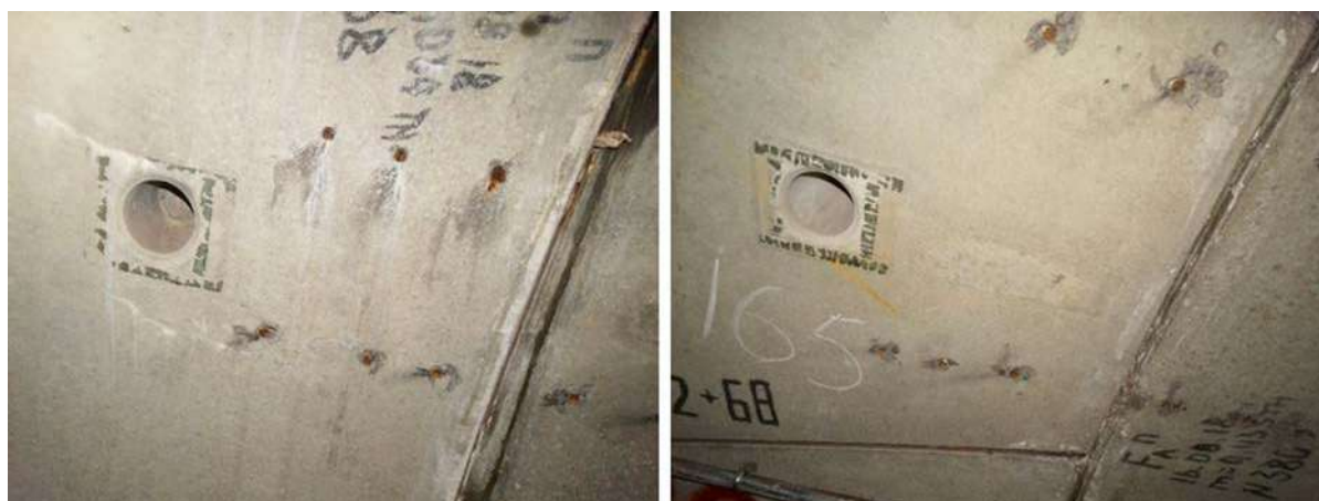
Рис. 7. Сколы бетона в местах установки болтов фиксации пластины
