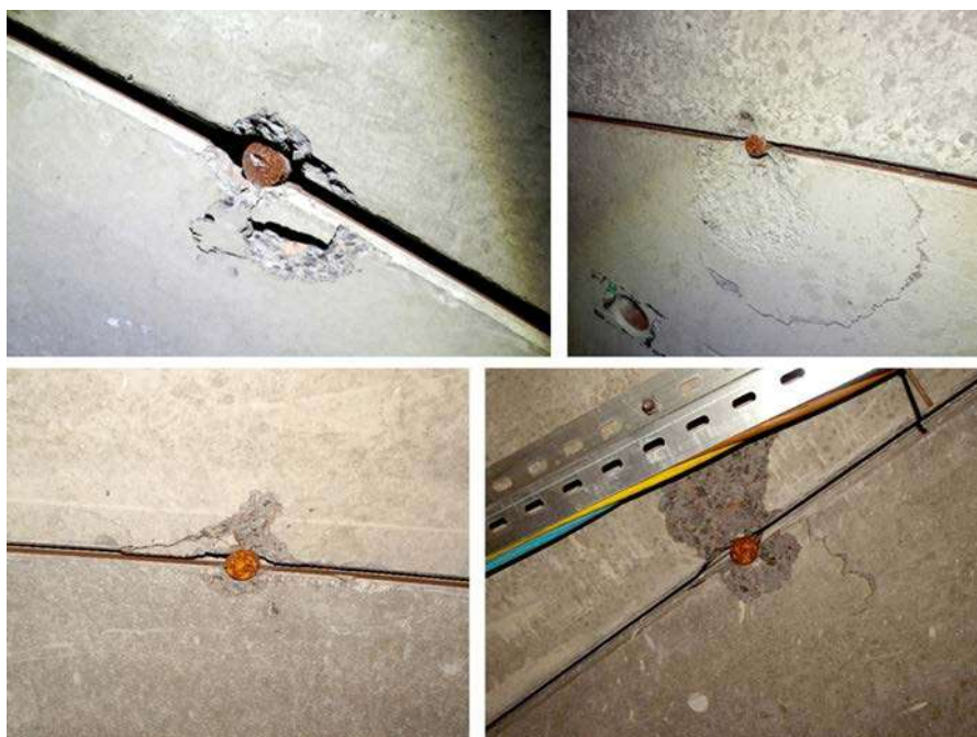
Рис. 4. Разрушение бетона в местах концентрации напряжений в стыке
