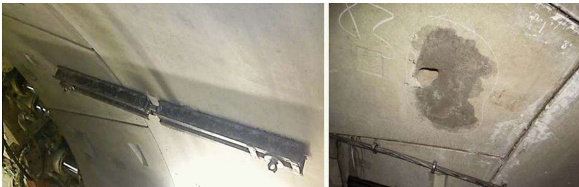
Рис. 6. Вид струбцины и разрушение бетона в местах концентрации напряжений у тампонажного отверстия
